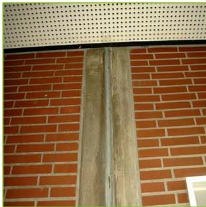
Gebäudedehnungsfuge im Innenbereich mit ca. 16 % PCB
